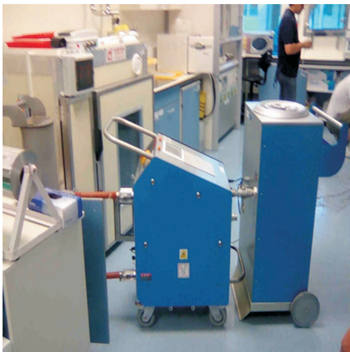
Ryc. 3. Rozmieszczenie generatora ARD 1000 w pomieszczeniu
